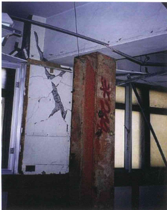
(九) 樑柱接合處破壞 ，樑端45度裂縫
